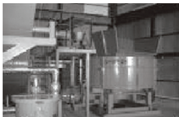
【写真2-14 整備された各種設備】
