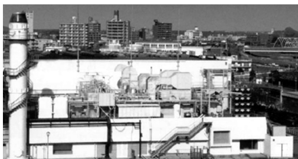
【写真2-13 整備された常用発電設備】
