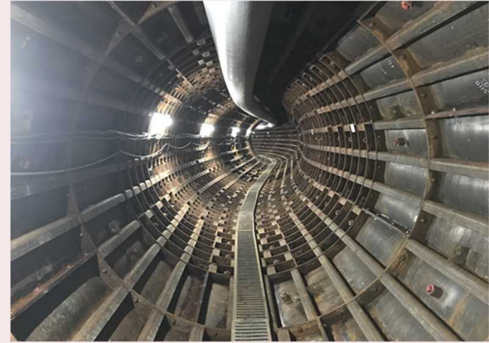
▲シールドトンネルの様子 多摩南北幹線は、令和4年度に整備が完了し、運用を開始しました。
