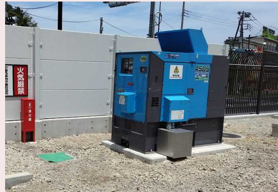
▲程久保増圧ポンプ所(非常用発電設備) 非常用発電設備を整備しました。
