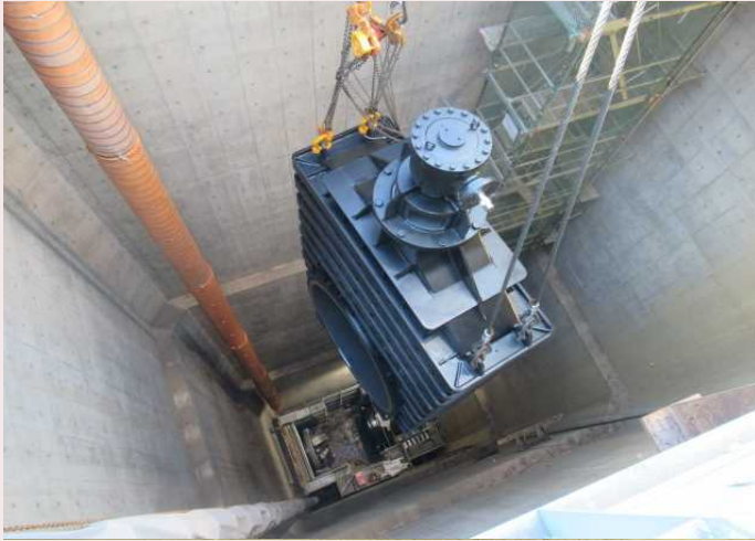
▲制水弁の吊り下ろし状況 第二朝霞上井草線(仮称)では、トンネル内の配管工事を実施しました。
