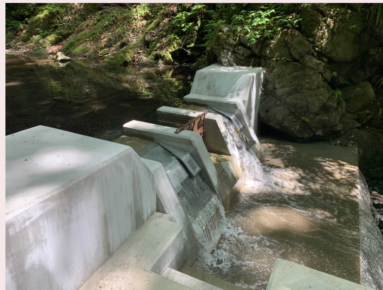
▲カロー谷取水所 カロー谷取水所において、取水施設の改良(ウォータースクリーン設置)を実施しました。
