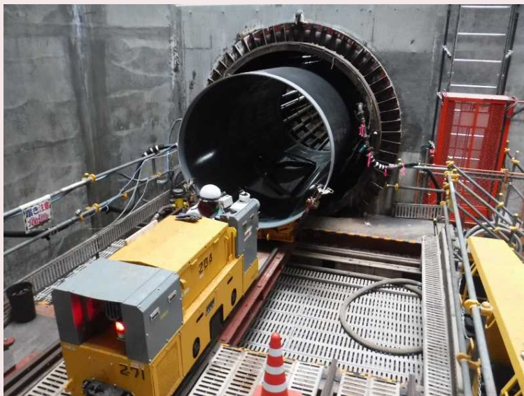
▲導水管布設工事における管の運搬状況(東村山境線(仮称)) トンネル内配管等の工事を実施しました。
