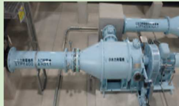
▲小水力発電設備
