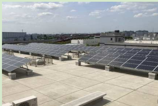
▲太陽光発電設備
