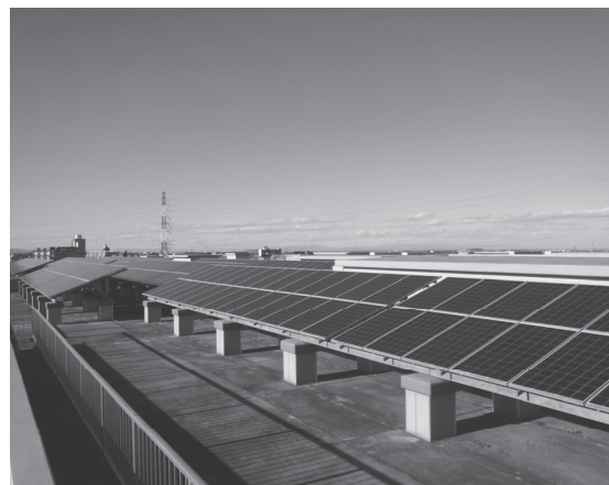
太陽光発電設備
