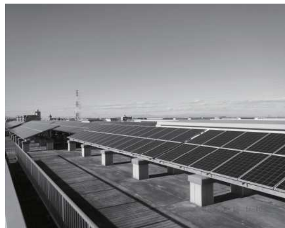
太陽光発電設備
