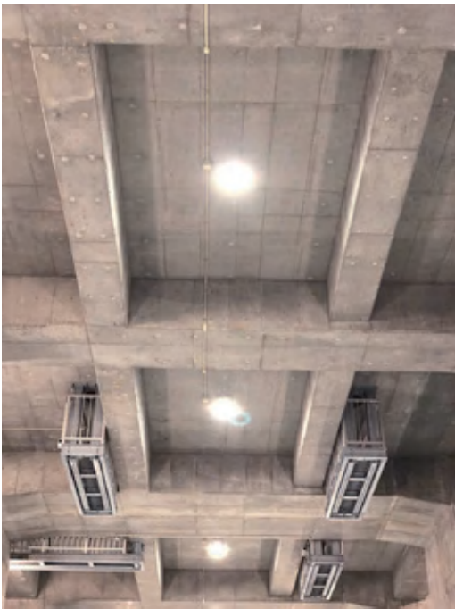
LED 照明の例（金町浄水場）
