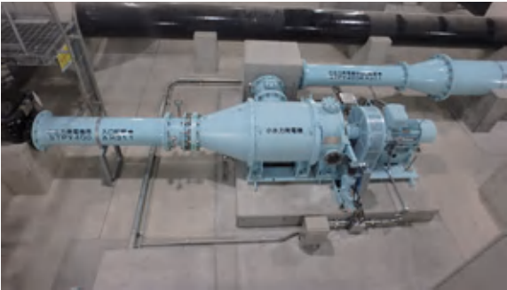
小水力発電設備（江北給水所）
