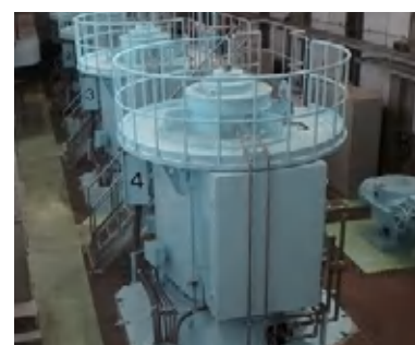
省エネ型ポンプ設備 (上井草給水所)
