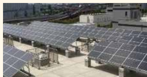
太陽光発電設備
