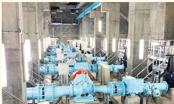
省エネ型ポンプ設備（清瀬梅園給水所）
