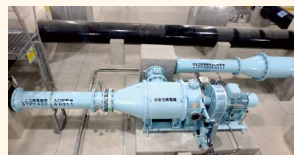
小水力発電設備
