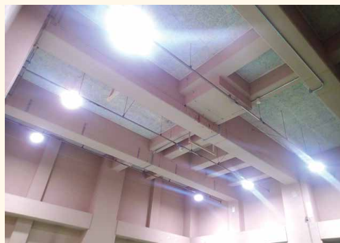
LED 照明（東村山浄水場）
