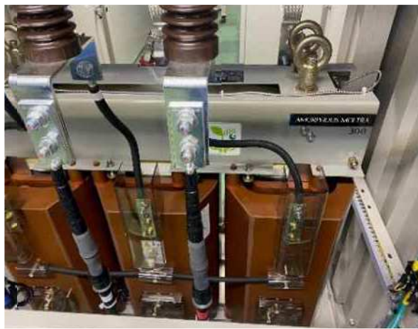
変圧器の例（八雲給水所）
