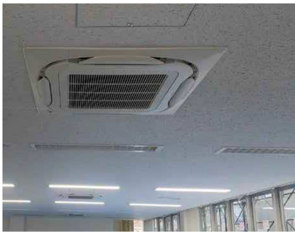
空気調和設備の例（東部建設事務所）
