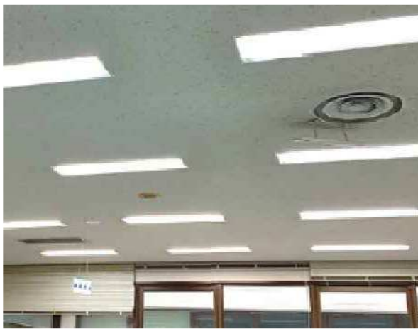
LED照明の例（三郷浄水場）
