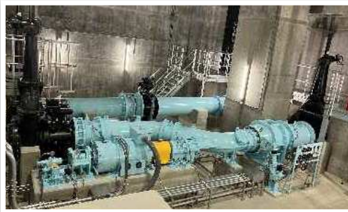
小水力発電設備 (上北沢給水所)
