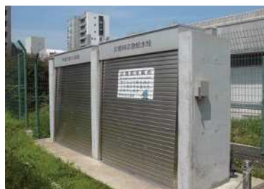
▲シャッター型応急給水施設
