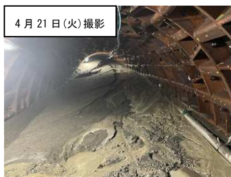
写真-4 土砂流入状況（到達立坑側から撮影）
