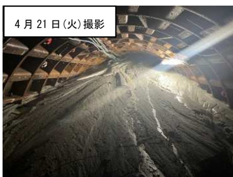
写真-3 土砂流入状況（発進立坑側から撮影）
