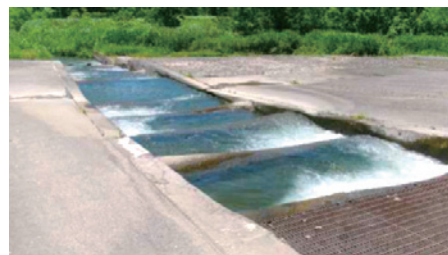
魚道（羽村取水堰）
