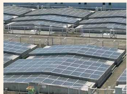
三郷浄水場の太陽光発電設備（ろ過池覆蓋）
