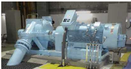
省エネ型ポンプ設備（玉川給水所）
