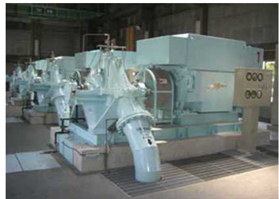
省エネ型ポンプ設備（稲城ポンプ所）
