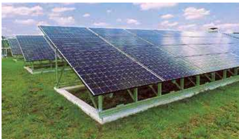
太陽光発電設備（上北台給水所）
