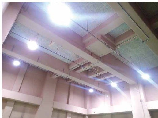
LED照明の例（東村山浄水場）
