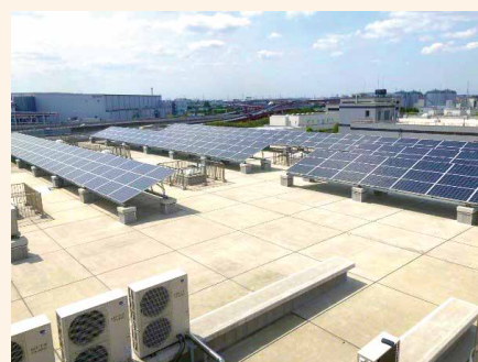
三郷浄水場の太陽光発電設備(第二排水処理所屋上)
