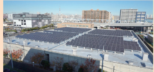
江東給水所の太陽光設備
