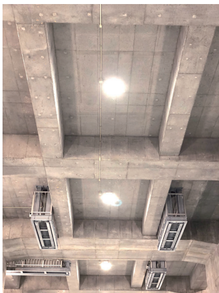
LED 照明の例 (金町浄水場)
