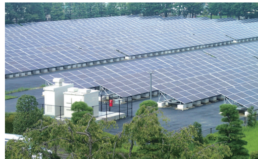
太陽光発電設備 (配水池上部)
