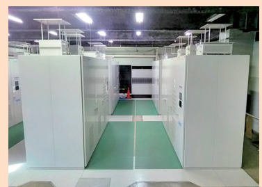
送水ポンプ用インバータ装置
