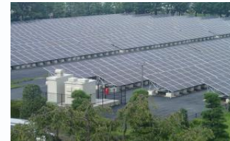
太陽光発電設備
