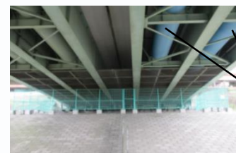
水道管 (添架管)
