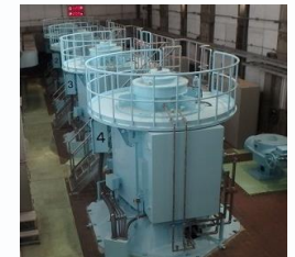
省エネ型ポンプ設備
