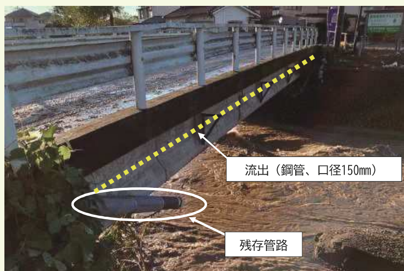
<令和元年東日本台風による添架管の流出 (玉の内橋) (東京都日の出町) >
