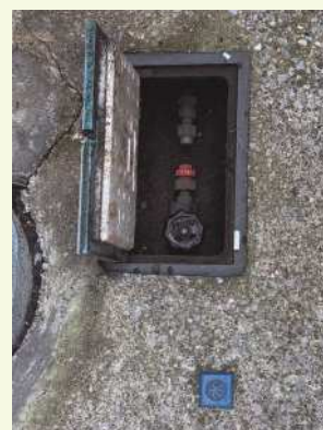
<長期間水道メータが 取り外されている給水管>
