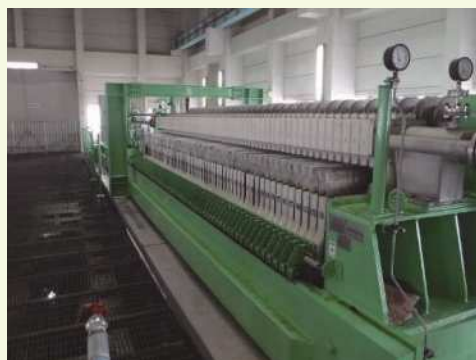
<排水処理設備（脱水機）>
