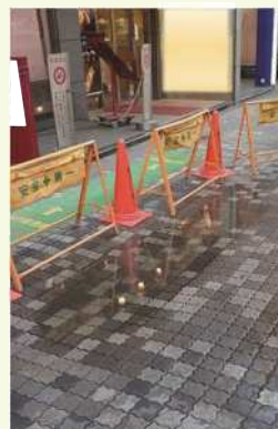
&lt;給水管漏水（舗装へ浸出）&gt;
