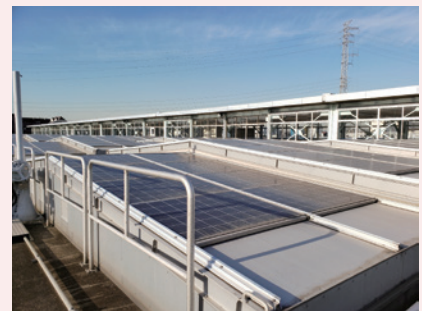
朝霞浄水場の太陽光パネル
