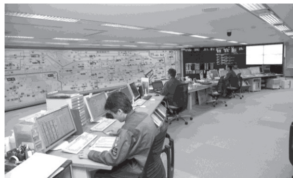
水運用センター監視室
