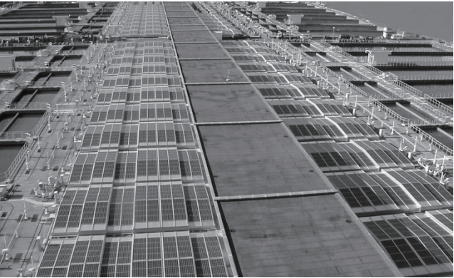
太陽光発電（朝霞浄水場）
