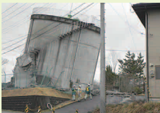
余震により倒壊した配水塔
