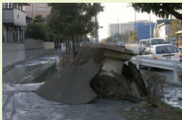
液状化により隆起したマンホール（下水道施設）
