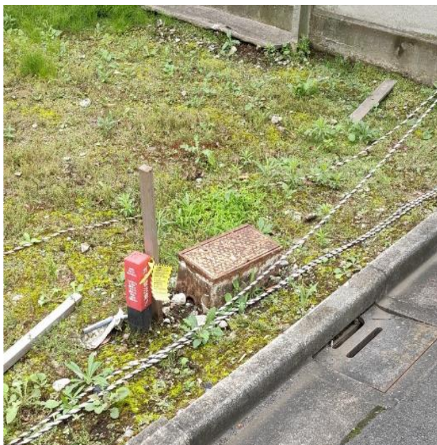
▲使用見込みがないまま放置されている給水管
