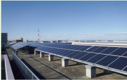
▲太陽光発電設備
