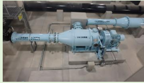
▲小水力発電設備
