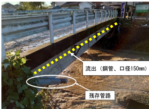
▲令和元年東日本台風による添架管の流出 (玉の内橋) (東京都日の出町)
