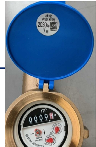
水道メーター
