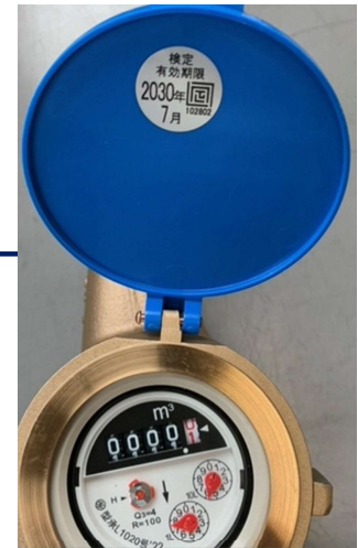
水道メーター
