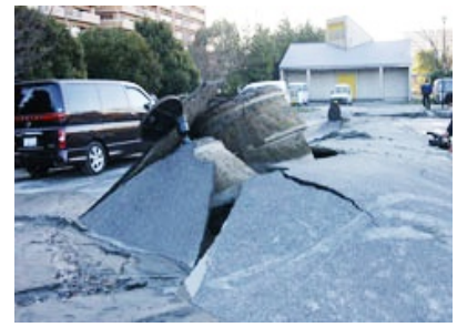
液状化により隆起した マンホール(下水道施設) (千葉県浦安市)
