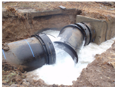
大口径送水管(φ 2400 mm)の 抜け出しによる被害 (宮城県白石市周辺 仙南仙塩広域水道)
