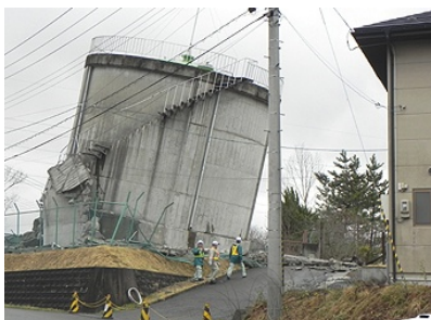
余震により倒壊した配水塔 (岩手県一関市 沢配水池)
