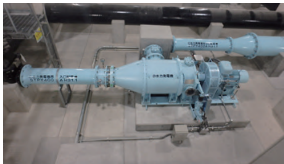
小水力発電設備（江北給水所）
