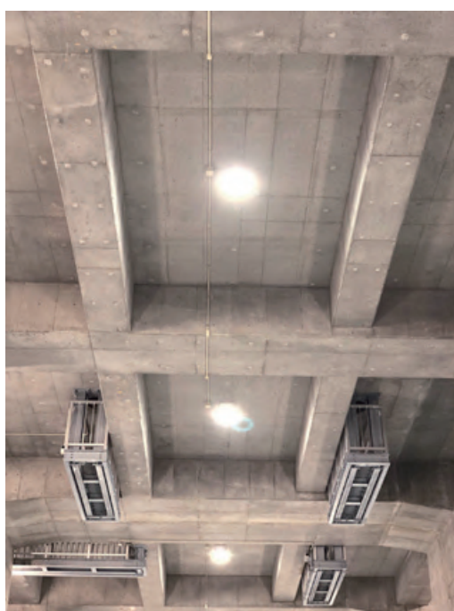
LED照明の例（金町浄水場）
