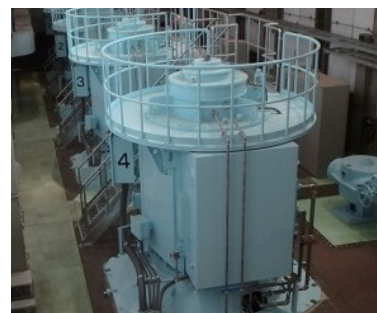
省エネ型ポンプ設備 (上井草給水所)
