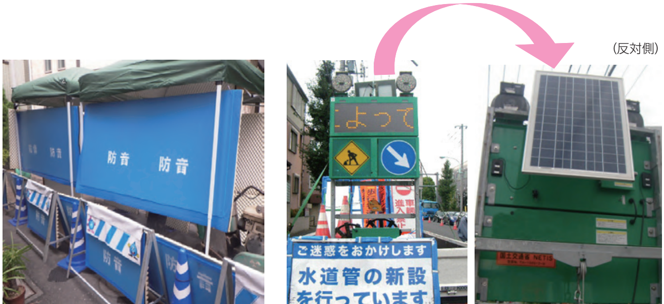
防音パネルによる騒音対策
