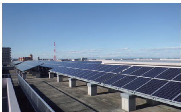
建屋屋上部の太陽光発電設備 (朝霞浄水場)
