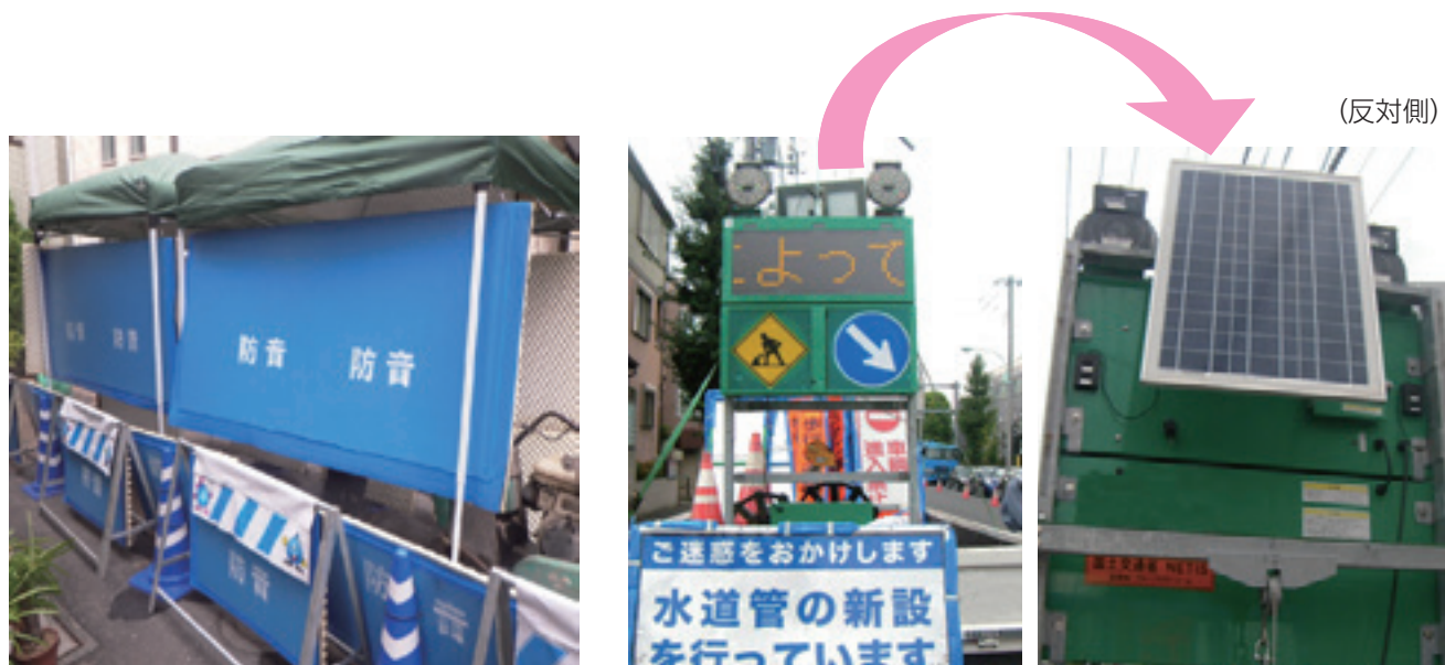
防音パネルによる騒音対策
