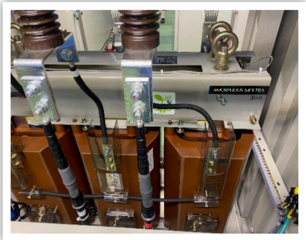
変圧器の例（八雲給水所）
