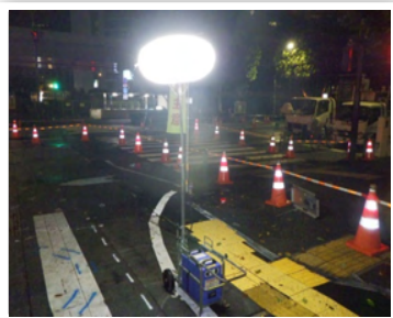
ポータブル電源の使用による騒音対策
