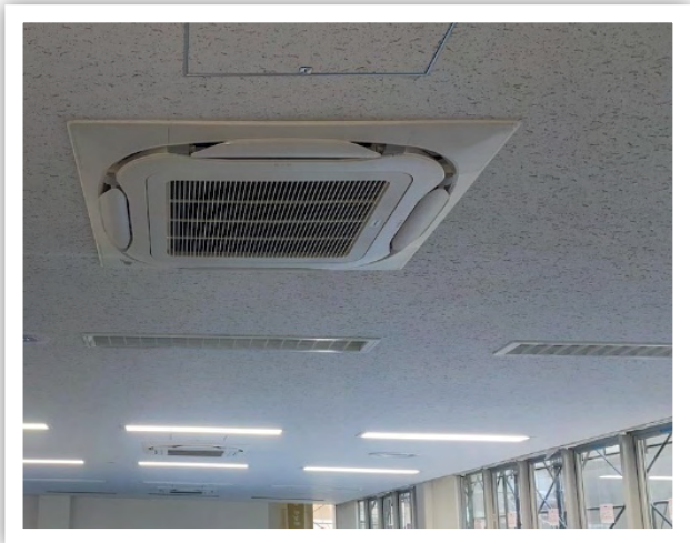
空気調和設備の例（東部建設事務所）
