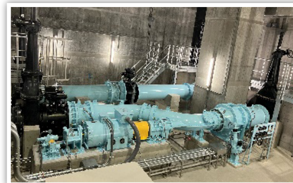
小水力発電設備（上北沢給水所）
