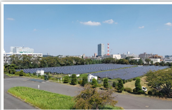
太陽光発電設備（東村山浄水場）
