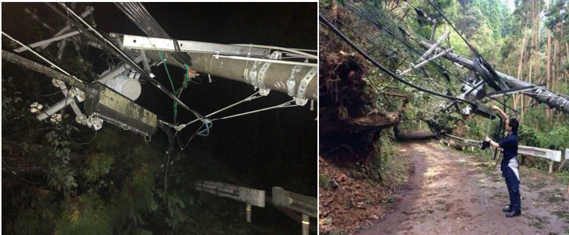
電柱の破損の状況（山間地域）
