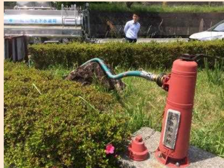
給水車への給水施設
