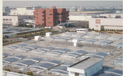
▲ 太陽光発電設備（三郷浄水場）
