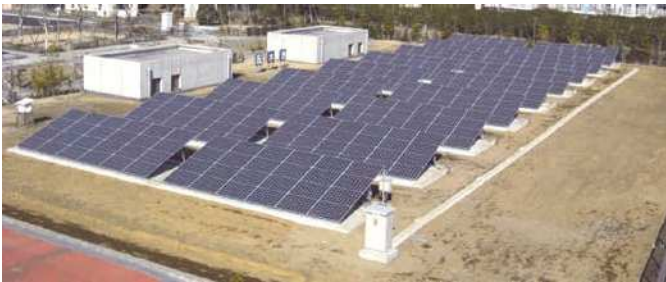
配水池上部に設置した太陽光発電設備
