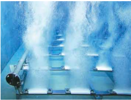
オゾン接触池
