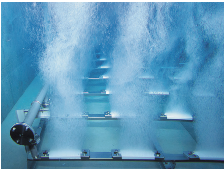
オゾン接触池
