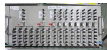
【Fig.9】 Panel example (Relay Panel)
