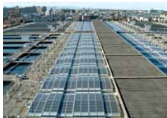
▲太陽光発電設備（朝霞浄水場）
