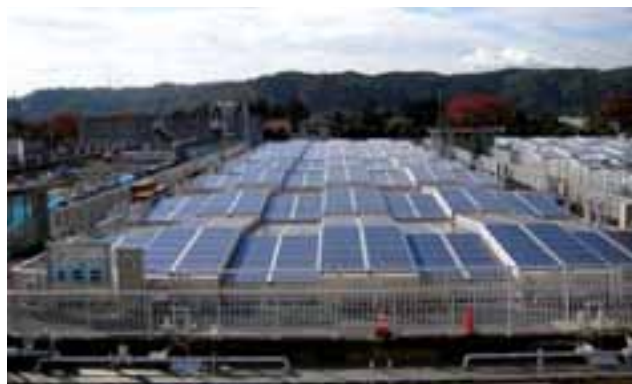
▲太陽光発電設備（小作浄水場）
