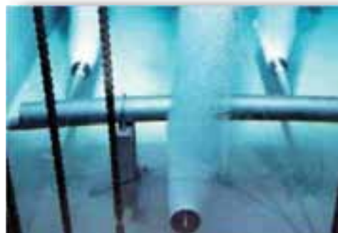
▲高度浄水施設（オゾン接触池）
