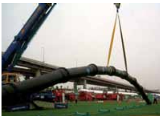
▲抜け出し防止継手の水道管
