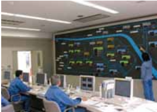
▲水道施設の運転管理(東京水道サービス(株))
