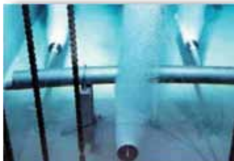
▲高度浄水施設(オゾン接触池)
