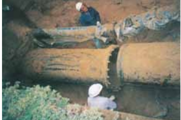
▲被害を受けた水道管（阪神・淡路大震災） （写真提供：神戸市水道局）
