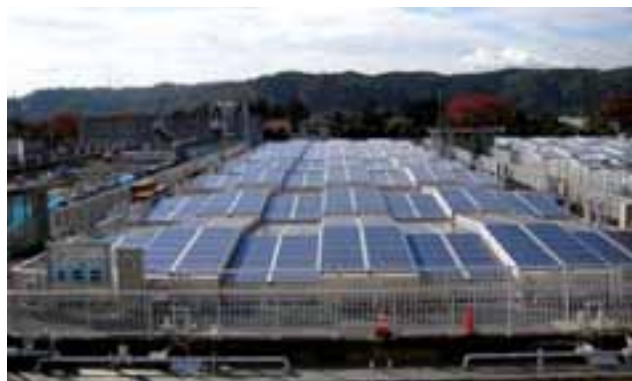
▲太陽光発電設備（小作浄水場）
