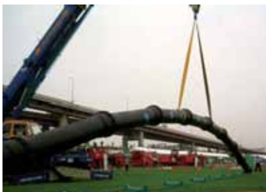
▲抜け出し防止継手の水道管
