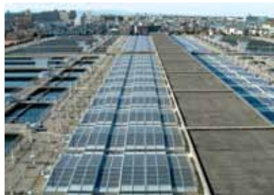
▲太陽光発電設備（朝霞浄水場）
