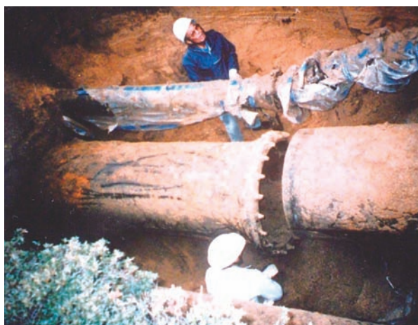
▲阪神・淡路大震災での被害水道管継手部の抜け出し（φ800mm）写真提供：神戸市水道局
