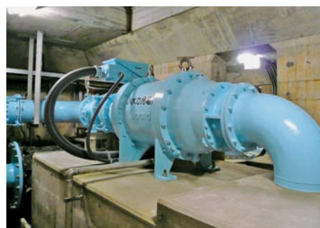
▲小水力発電設備（亀戸給水所）
