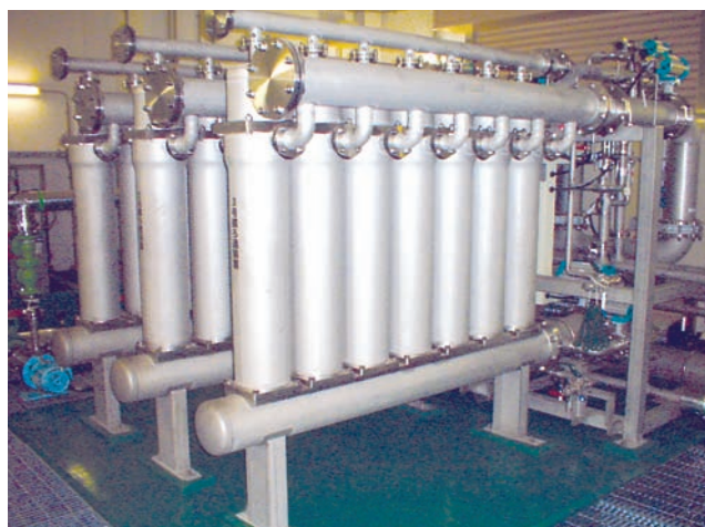
▲膜ろ過施設の導入例（青梅市 御岳山浄水所）
