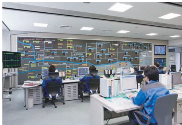
▲多摩地区の水道施設の集中管理を行う多摩水道統合管理室
