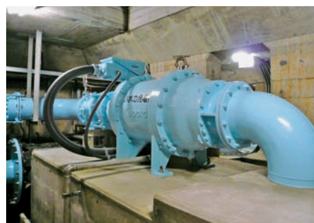
▲小水力発電設備（亀戸給水所）
