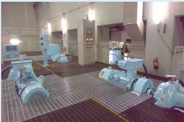
▲ 省エネ型ポンプ設備（江東給水所） 江東給水所の配水ポンプを更新しました。
