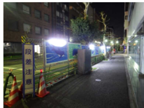
○歩行者道路にLED 照明を設置
