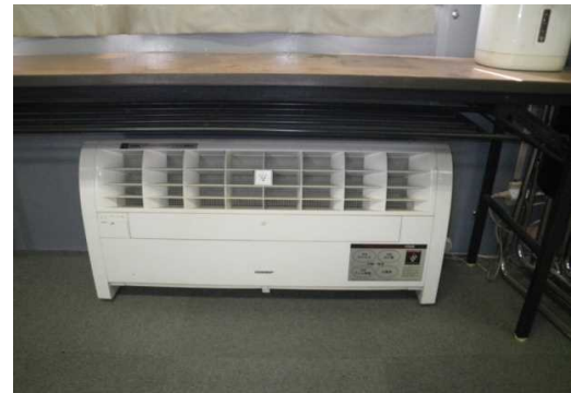
○空気清浄機を設置
