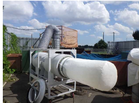
○フィルター付管内換気設備により、坑内の粉塵等をクリーンな状態で排気
