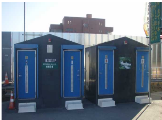
○洗浄水を再利用した循環式構造による環境対応型トイレを設置
