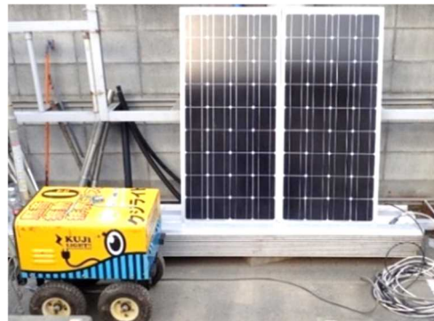
○ハイブリッド蓄電式バッテリーの使用
