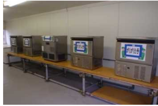
○熱中症対策のため製氷機を設置
