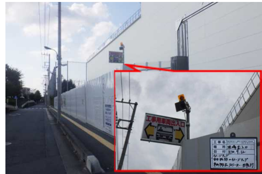
○車両出入口に注意喚起スピーカー設置
