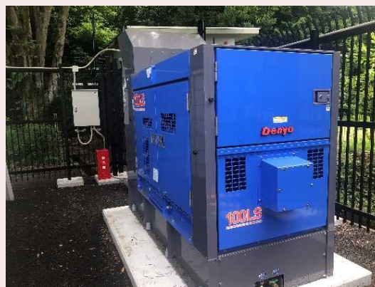
▲上恩方増圧ポンプ所(非常用発電設備) 非常用発電設備を整備しました。
