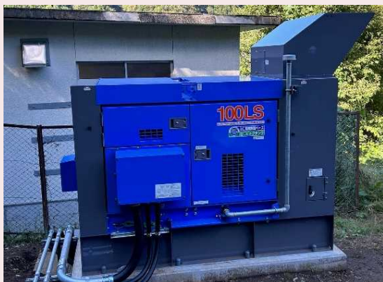
▲うなざわ第一配水所(非常用発電設備) 非常用発電設備を整備しました。
