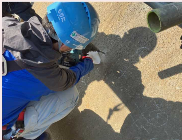
▲中性化による劣化状況についての調査
