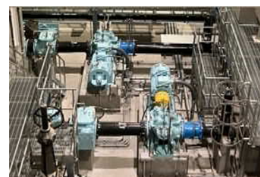
▲省エネ型ポンプ設備の導入 (上北沢給水所の配水ポンプ)
