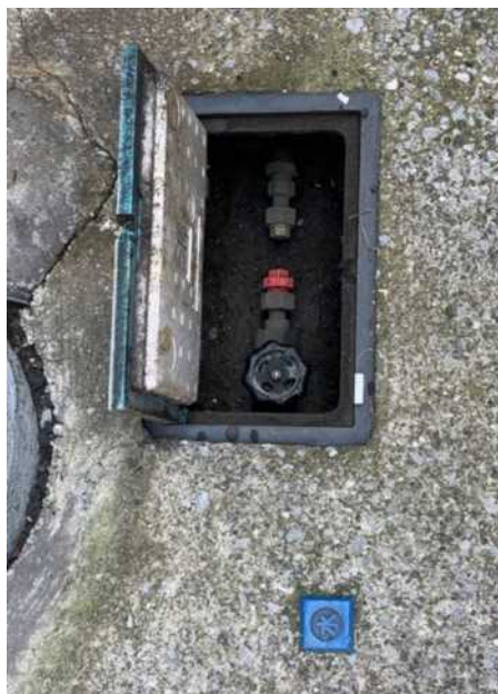
図15 長期間水道メータが 取り外されている給水管
