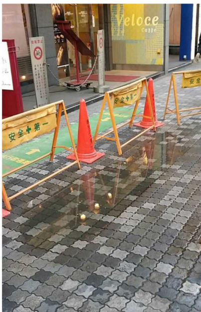
図14 給水管漏水 (舗装へ浸出)
