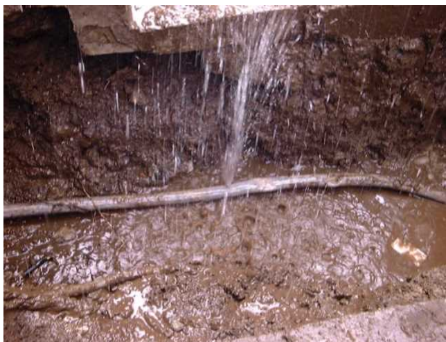
図 11 鉛製給水管の漏水状況
