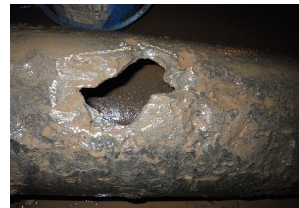
図2 鋳鉄管の腐食漏水
