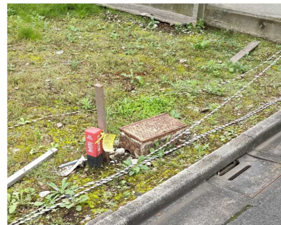
図16 使用見込みがないまま 放置されている給水管
