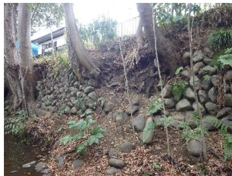
(既設構造物破損による崩落)
