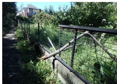
(枝折れにより民家の柵を損傷)
