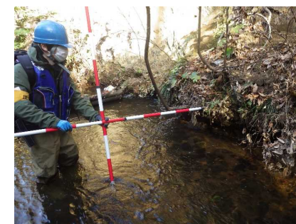
④流水による法尻浸食
