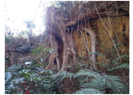
オーバーハング状法面
