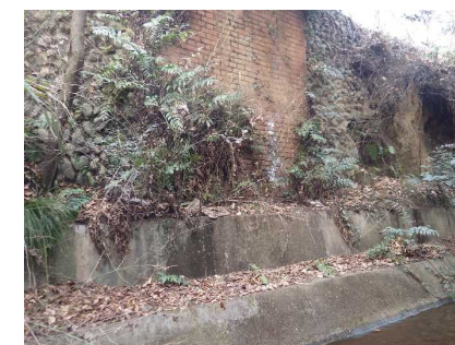
⑤既設構造物破損による崩落
