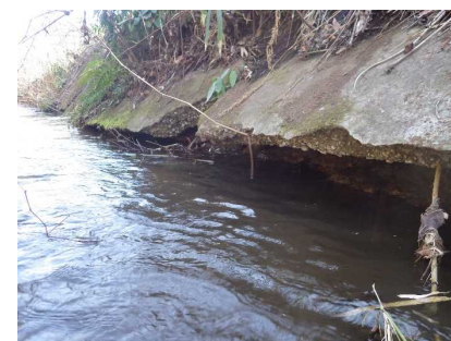
④流水による法尻浸食
