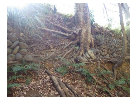
⑤既設構造物破損による崩落
