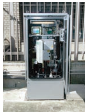
給水栓自動水質計器
