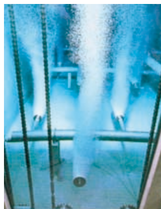
オゾン接触池
